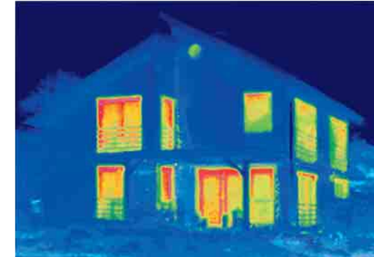
Infraroodopnamen, thermografieën, laten duidelijk zien waar er warmte-energie ontsnapt uit het huis. Rood staat voor warmte en bijgevolg een hoog energieverlies.
